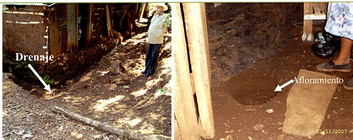
Fotografías que muestran el exterior de una vivienda, que es afectada por afloramientos de agua en su interior.
